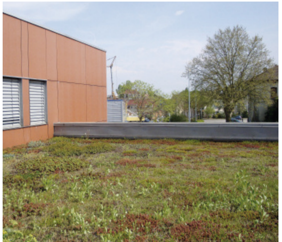
Terrasse végétalisée des bureaux de Maurice Di Giusto à Mulhouse-Dornach. Ce type de terrasse isole du froid comme du chaud, capte le CO2 et contribue à la bio-diversité. Il s'agit de plantes tapisantes posées en rouleaux sur le toit.
