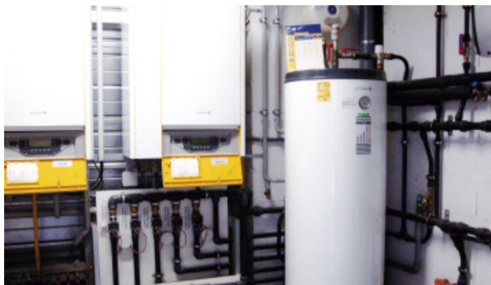
Une installation performante
